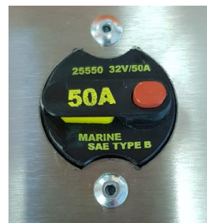
Sicherung aktiviert, Gerät betriebsbereit
